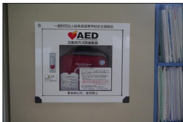
【本館1階 保健室前のAED】
